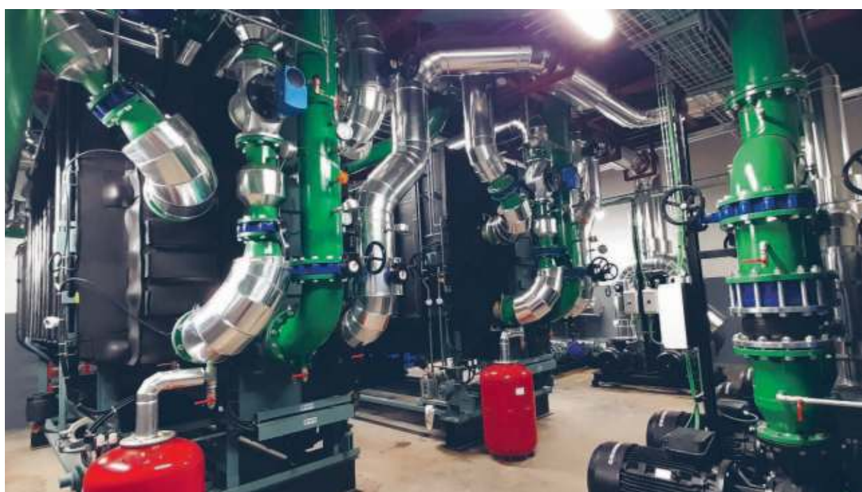
UNO DEI LOCALI DELL'IMPIANTO DI TRIGENERAZIONE REALIZZATO DA ELEKTRONORM A SERVIZIO DEL CED DI UNA PRIMARIA BANCA ITALIANA (3 MWEL) - PARMA
